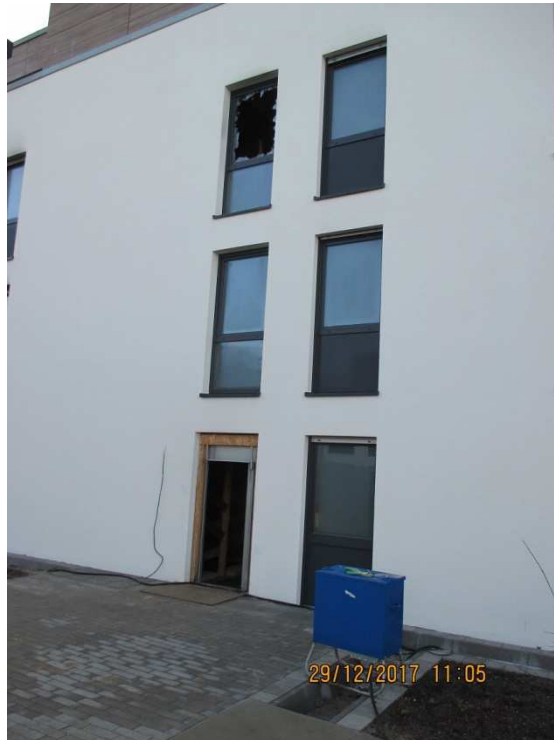
Abbildung 7 - Eingangssituation mit eingeschlagenem Fenster nach dem Brandereignis
