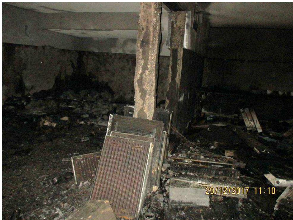
Abbildung 12 - Brandraum nach dem Brandereignis - es ist deutlich die Fortentwicklung des Brandes und die deutliche Brandlast zu erkennen
