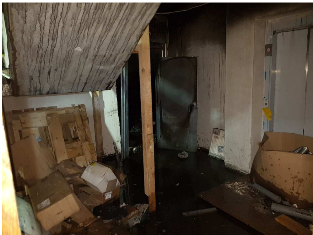
Abbildung 10 - Eingangsbereich zum Brandraum mit Treppenabgang im linken Bildbereich. In diesem Bereich hat sich auch der Angriffstruppmann im Draht verfangen. Die Wärmeeinwirkung auf die Brandtür lässt auf eine hohe Brandintensität schließen
