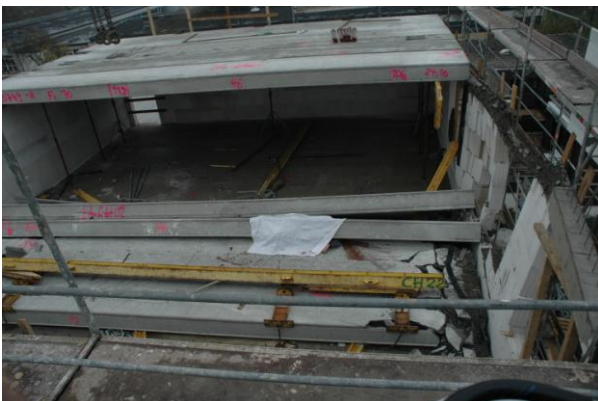
Bild: Einsturz von Spannbetonhohlplatten
