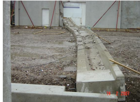
Bild: Einsturz eines Spannbetonfertigteilebinders
