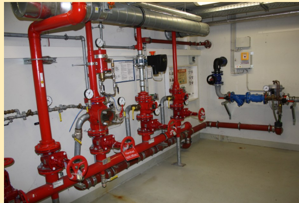
Sprinklerzentrale mit mehreren Alarmventilstationen
