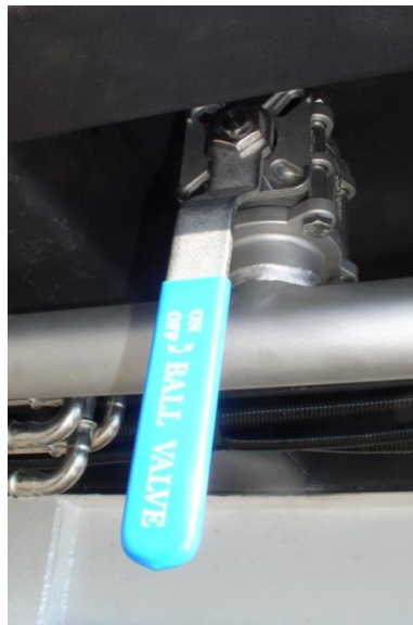
Abbildung 11: Wasserablaufventil (offen) [IdF NRW]
