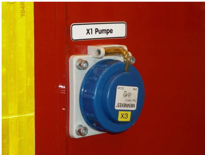
Abbildung 18: Steckdose Stromversorgung Abwasserpumpe [IdF NRW]
