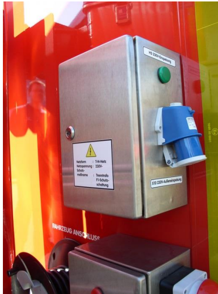
Abbildung 14: Fremdeinspeisung 230 V [IdF NRW]
